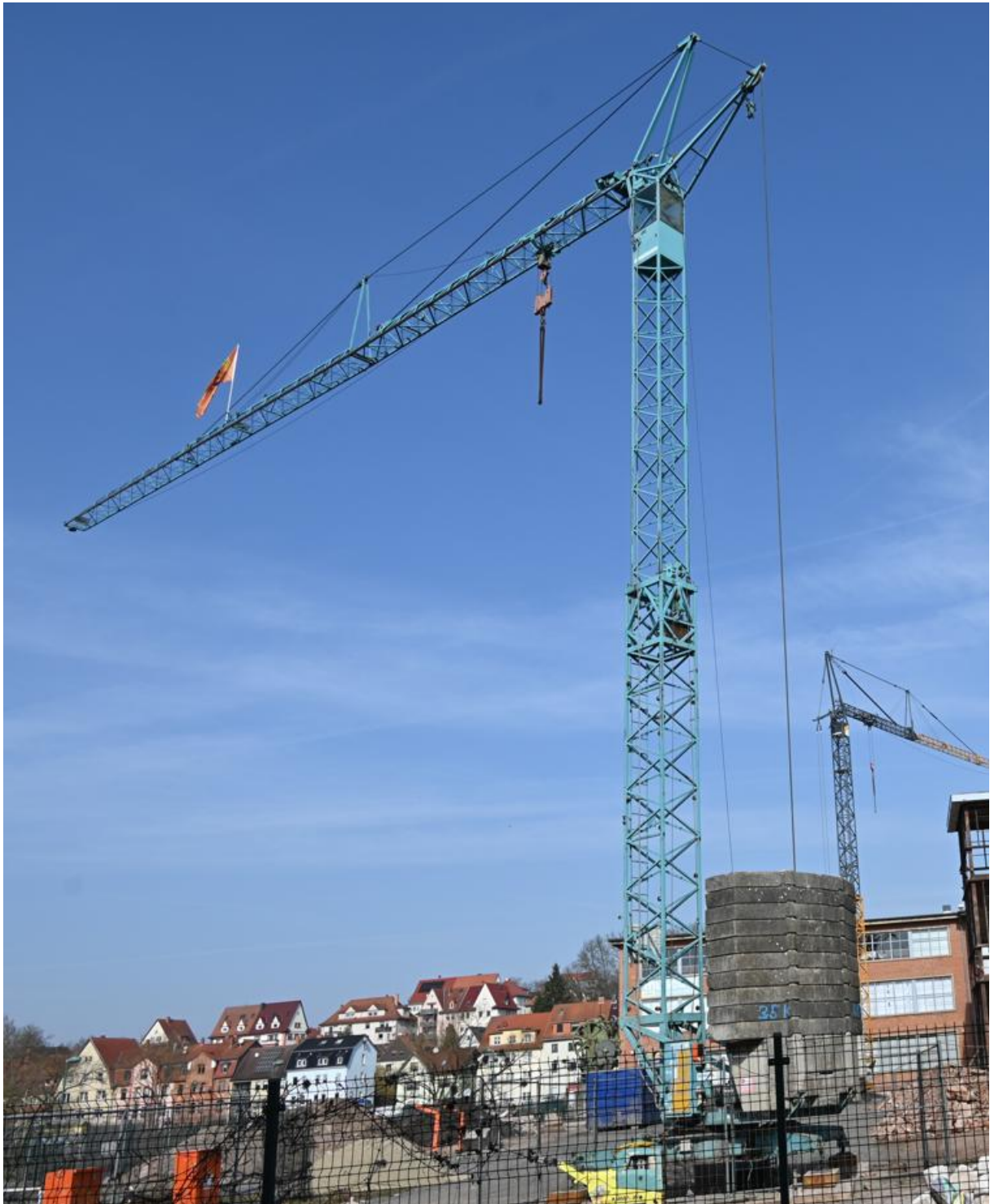
Liebherr 35 K in Eisenstadt D
