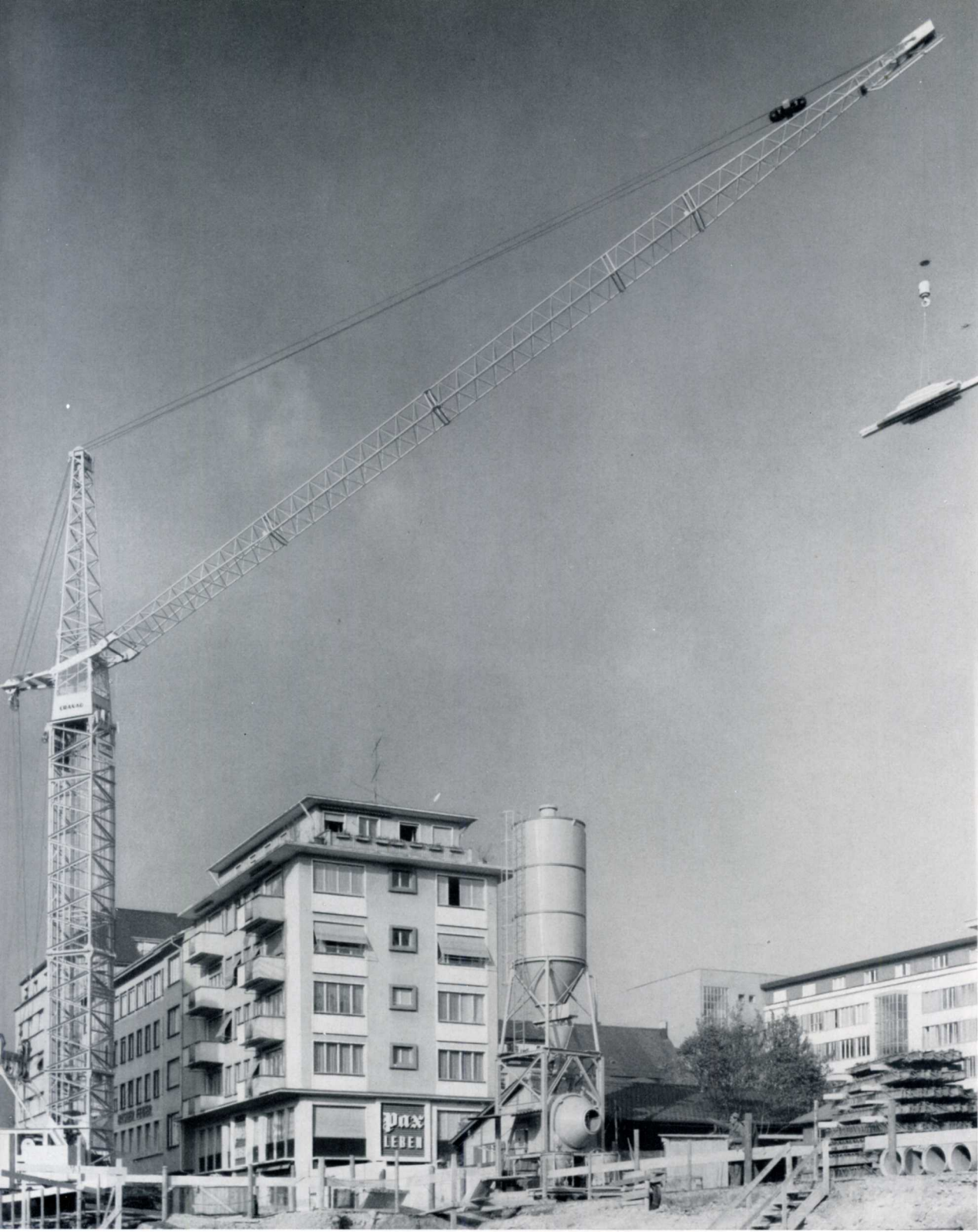
LIEBHERR-Turmdrehkran Form 45 A/55 (33 m Ausladung, Teleskopdrehsäule eingefahren) und automatische Zementdosieranlage mit LIEBHERR-Umkehrmischer 750 l beim Bau des neuen Stadthauses in Olten
