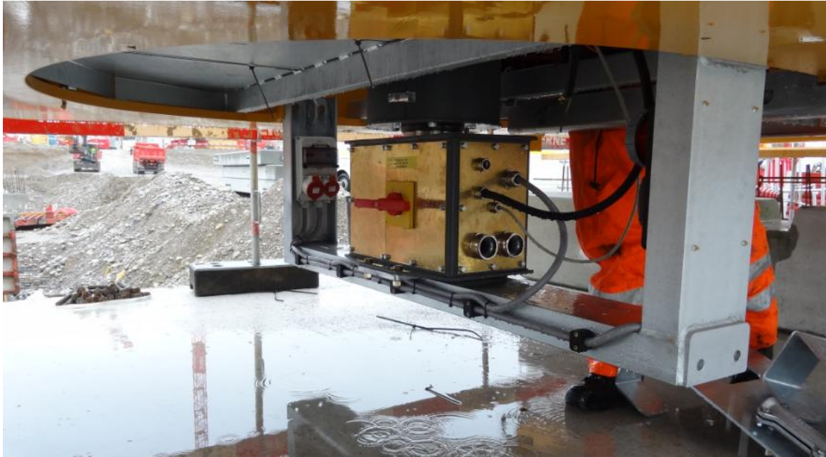
Schleifringunterteil und elektrischer Anschluss an der Drehbühne.
