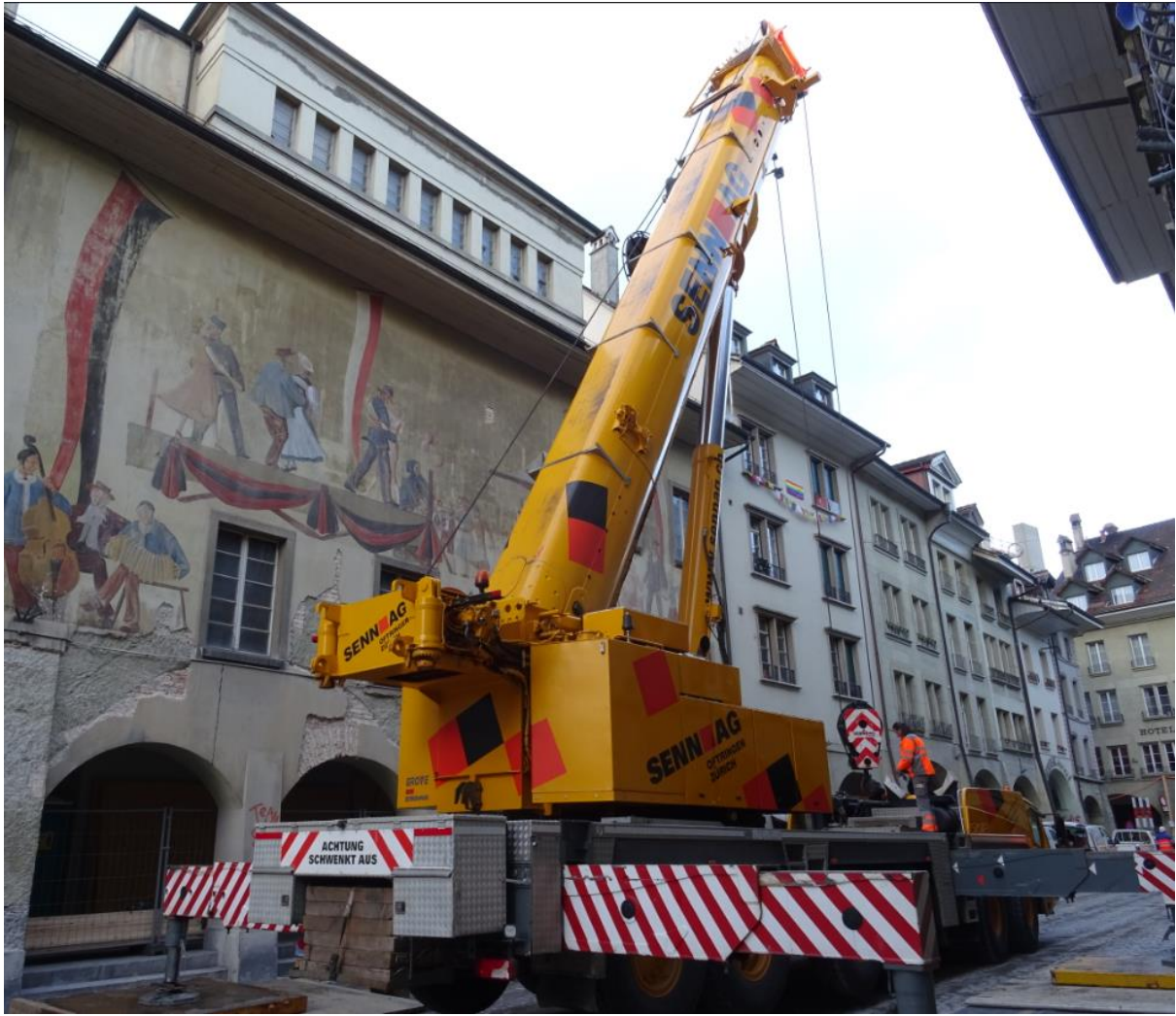
Die Störkanten (Dachkanten in der Rathausgasse).
