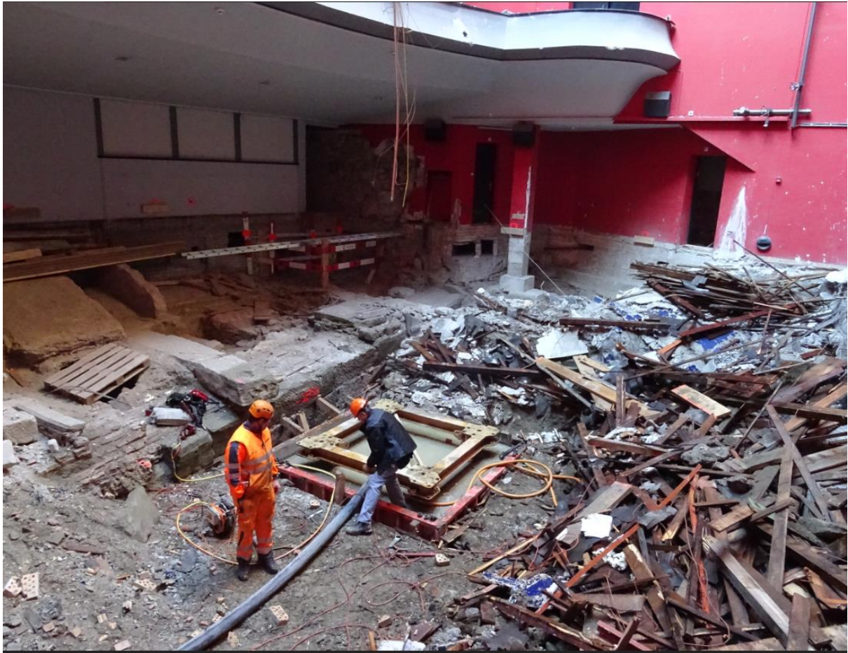
Der Ort, wo der Kran auf Fundamentanker montiert werden soll (Trümmerfeld des Abbruchs).
