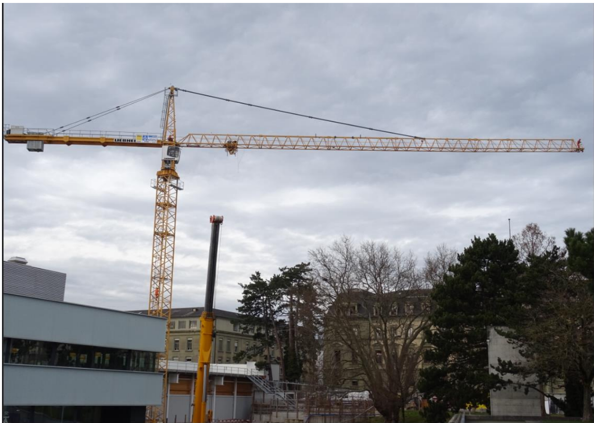
Der Kran steht, es müssen noch das Laufkatzen- und das Hubseil eingezogen werden. Die Litronic (Elektronik, Last und Arbeitsbegrenzungen) eingestellt werden.
