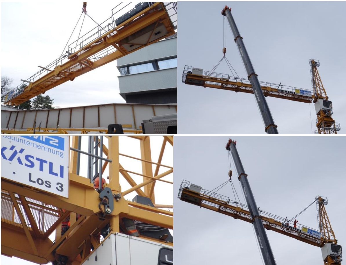
Montage des Gegenauslegers. Bei dieser Montage muss der Gegenausleger stark überzogen werden, damit die Abspannstangen montiert werden können. Die Abspannstangen auf dem Gegenausleger werden am Boden mit Kantholz bereits auf die Höhe des Geländers gelegt.
