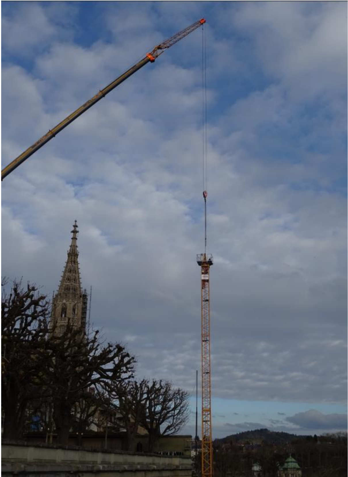
Montage des Drehkranzes (Königs) auf dem Turm. Hier werden die Verhältnisse sichtbar, die die notwendige Länge des Auslegers vom Mobilkran (92m) zur erforderlichen Distanz (Mobilkran zu Baukran 58m) für die Montage des Baukrans im Garten notwendig war.
