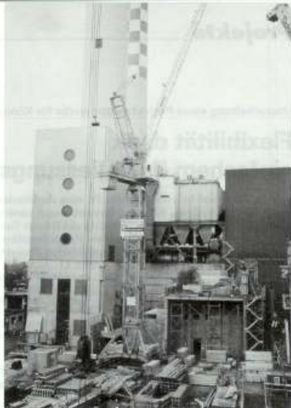
Ebenfalls im Einsatz: der erste Wolff-Wippkran WK 100-B auf einer Schweizer Baustelle.
