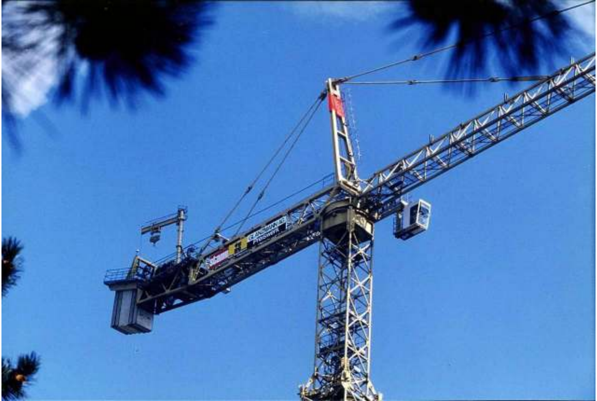
Der fertig montierte Kran. Gut ist der Hilfskran auf dem Gegenausleger zu erkennen
