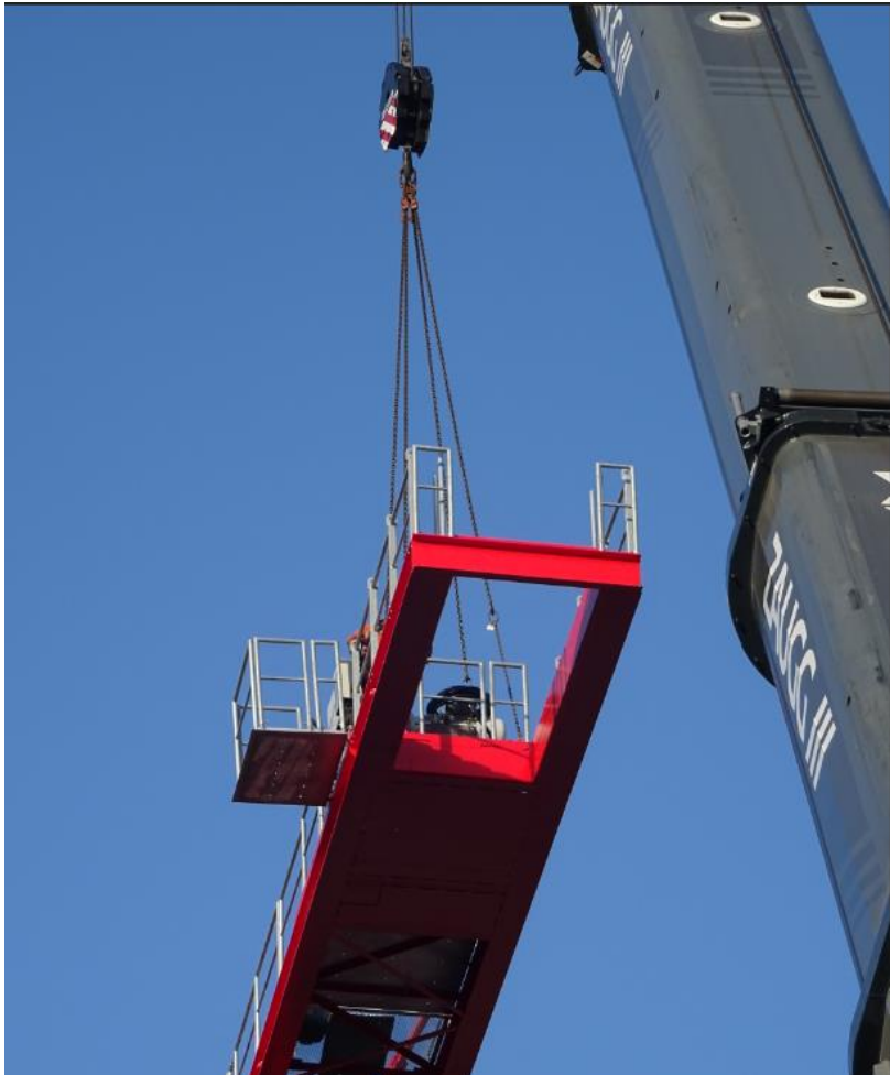
Heben, schwenken und montieren der Hubwindenplattform (HW 875 FU), Gewicht 3,535t auf dem Gegenausleger.
